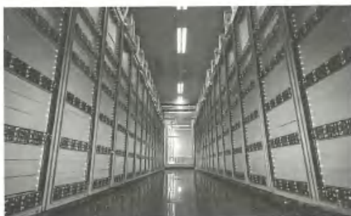
图 1.1-5 千岛湖数据中心
