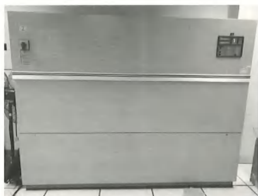
图 3.6-4 广东某银行使用的超过 23 年的进口风冷精密空调
