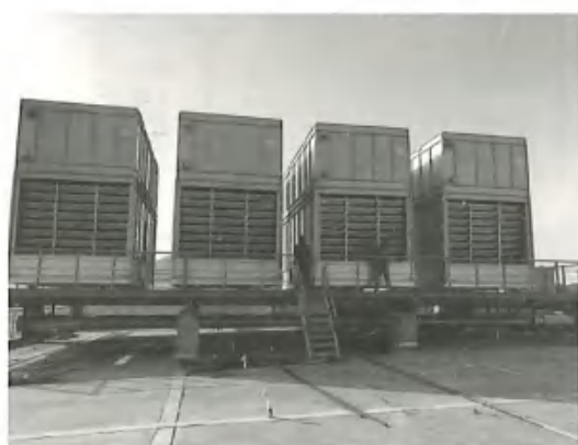
图 3.6-3 某数据中心闭式冷却塔安装实景
