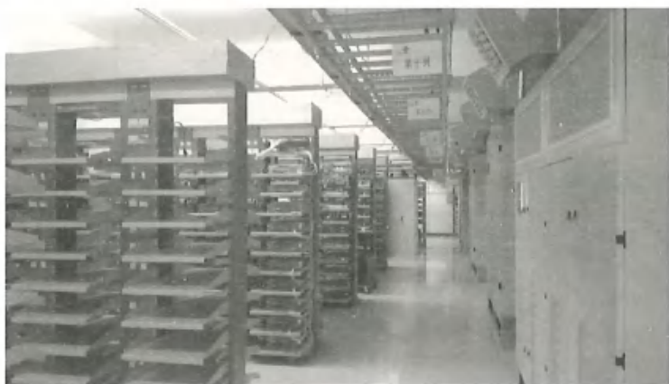
图 5.6-9 绥化市某通信数据中心
