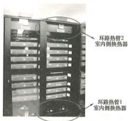
图 5.2-8 采用双级环路热管的内冷型机柜
