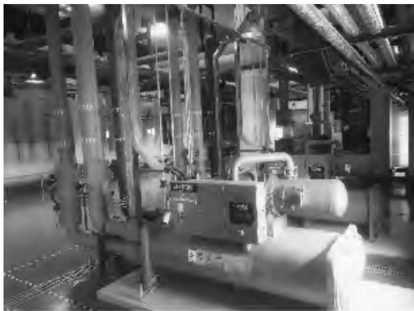
图 7.2-7 数据中心高温水源热泵
