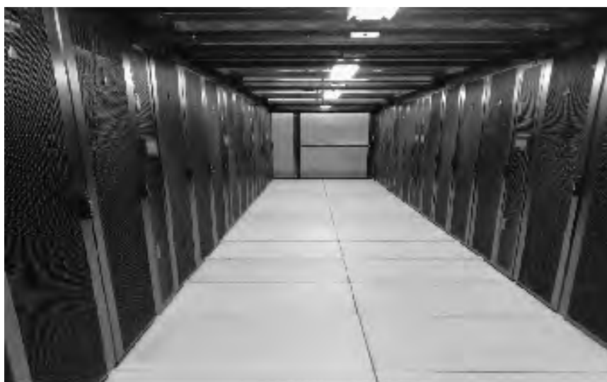
图 7.2-6 数据中心水冷列间空调机房
