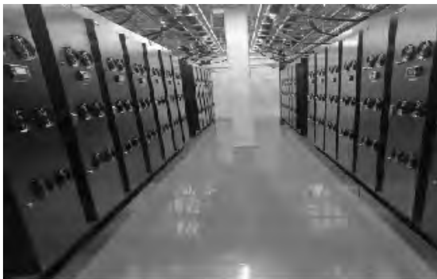
图 7.2-4 数据中心热管背板空调机房
