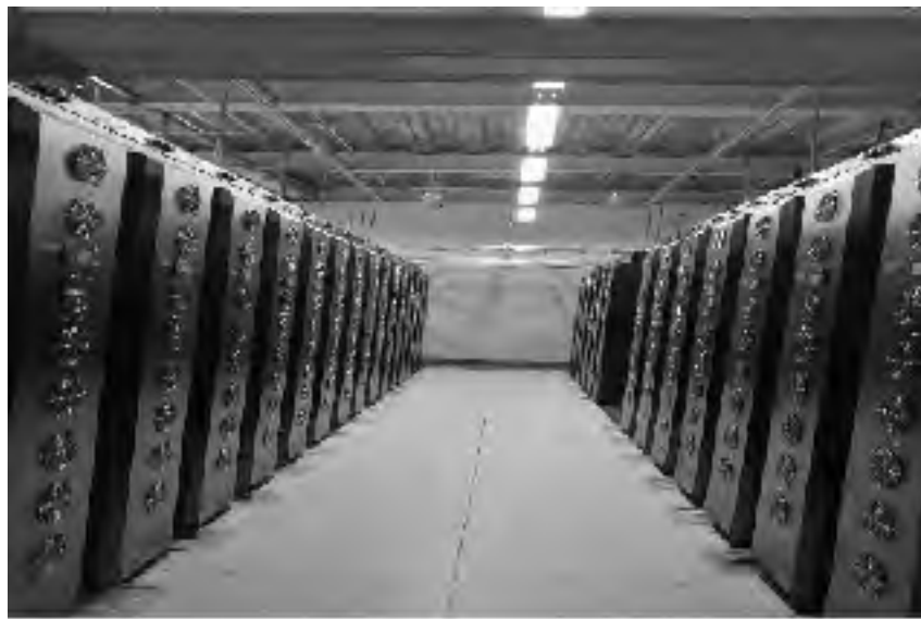
图 7.2-5 数据中心水冷前门空调机房
