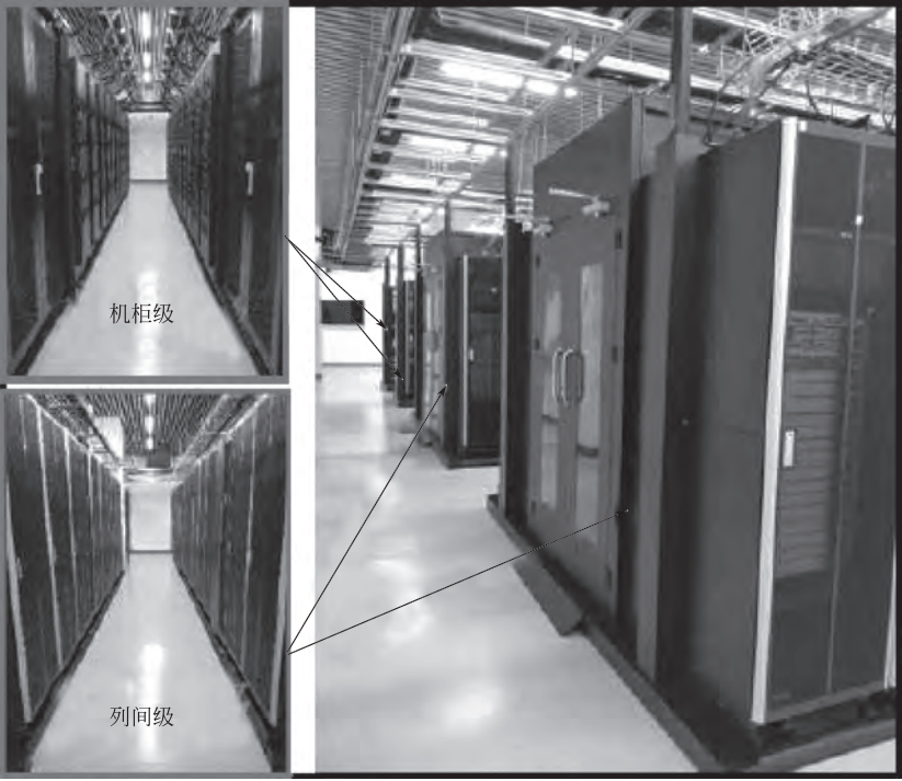
图 7.5-2 示范机房照片
