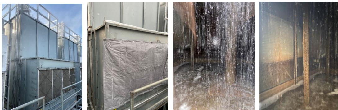
图 11 用在哈尔滨示范工程的间接蒸发冷却塔照片
